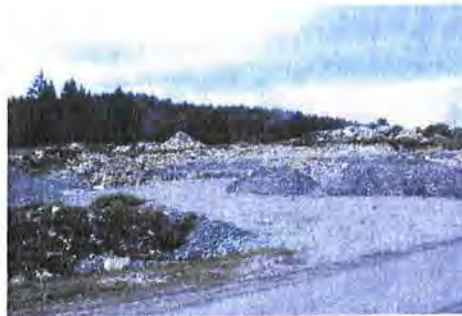
Vue de la parcelle depuis la route à l'est. Les terrassements avaient débuté. Cliché P. Collin
